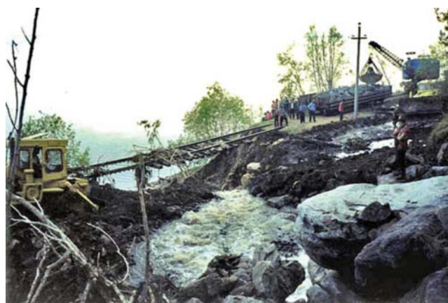
Рис. 2. Последствия схода селевого потока в июле 2001 г. на 117-м км западного участка КБЖД ( http://www.transsib.ru )
